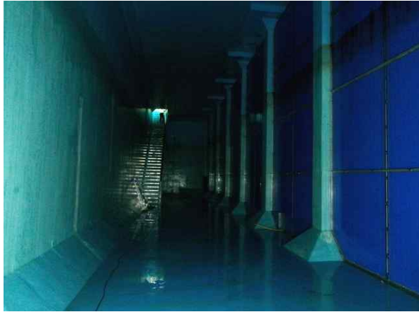
<배수지 1지 전경>
