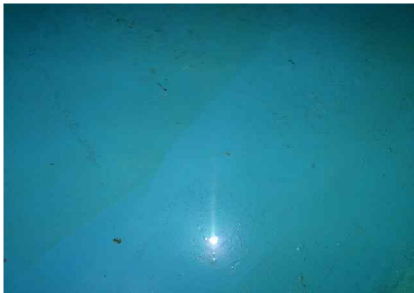
<1지 바닥슬래브 균열>
