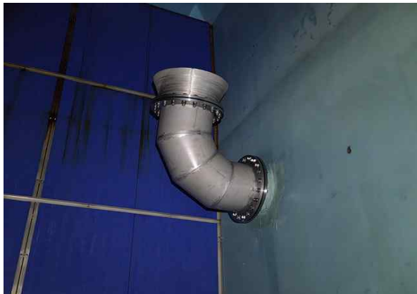
<1지 유입배관 양호>
