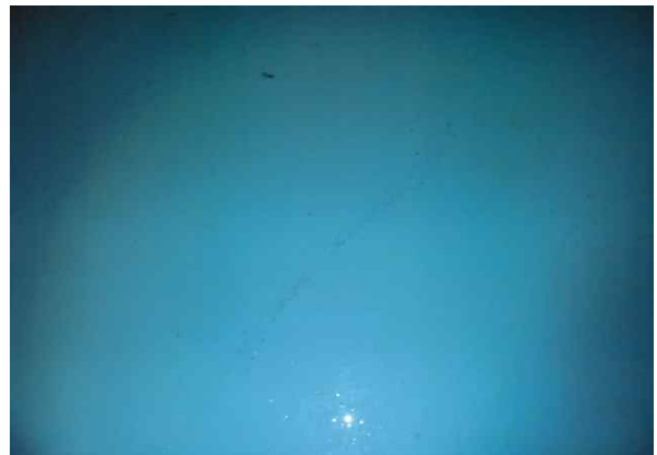
<2지 바닥슬래브 균열>
