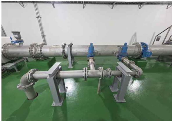
<유입밸브실 배관 양호>
