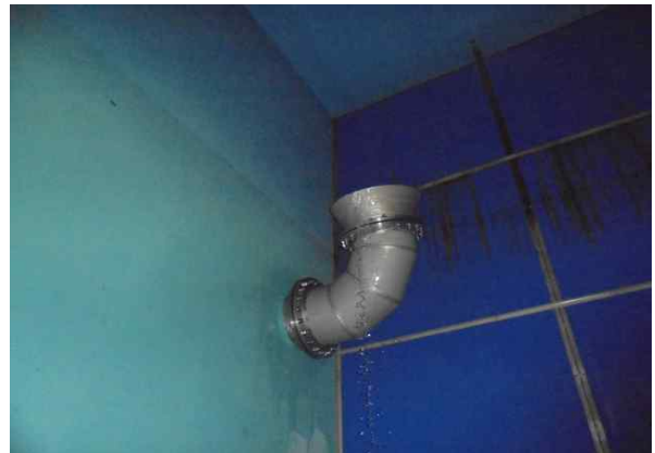
<2지 유입배관 양호>
